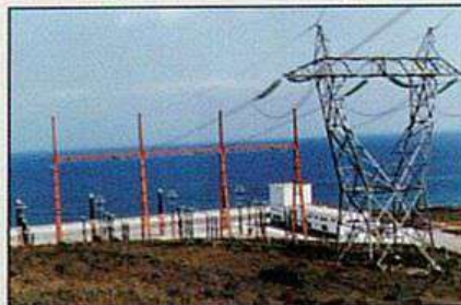
316 Pylônes électriques de l'O.N.E.
